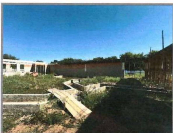
FABRICAÇÃO DE FÔRMA PARA PILARES E ESTRUTURAS SIMILARES, EM CHAPA DE MADEIRA COMPENSADA RESINADA, E = 17 MM. AF. 09/2020
