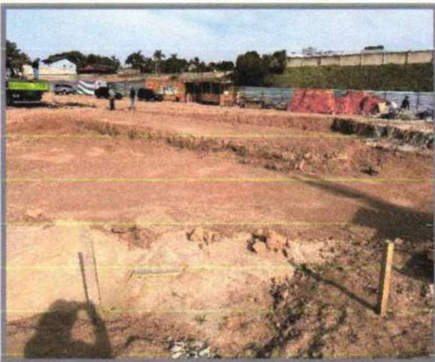
Abertura e preparo de caixa até 40 cm, compactação do subleito mínimo de 95% do PN e transporte até o raio de 1 km
