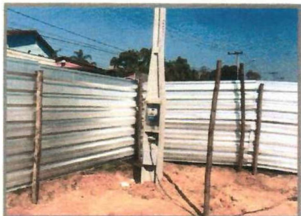
Figura 12: Caixa de inspeção, Haste de aterramento, Poste circular, Caixa de medição
